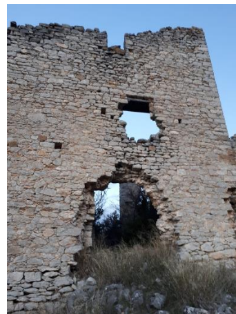
Estat actual de la façana del castell de Vilanoveta. La fotografia evidencia el seu estat ruïnós. E. Oliva.
