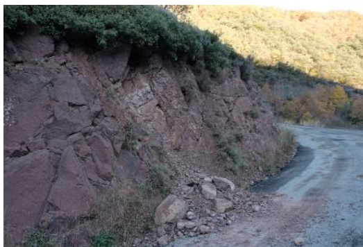
Alteració de l'aflorament i desprendiments al peu de la pista. J. Panisello.
