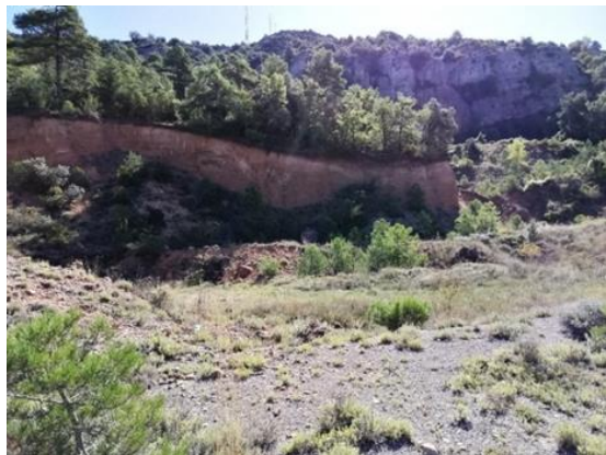
Gravera en desús sobre la carretera C-1412b, presenta aflorament força verticalitzats que podrien presentar cert risc de desprendiments de blocs o còdols. X. Mir.
